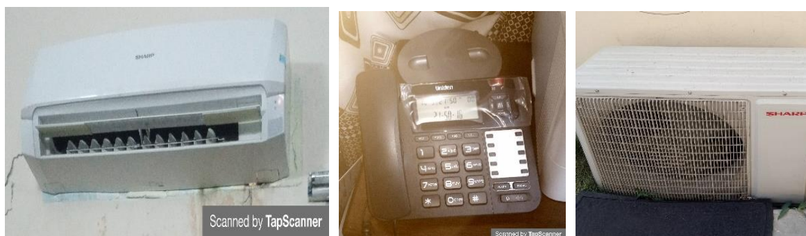
Photo 117 : Montrant les climatiseurs et les matériels téléphoniques.
