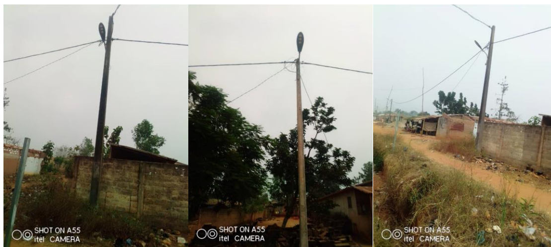
Photo 57 : Montrant les lampadaires électriques placés
