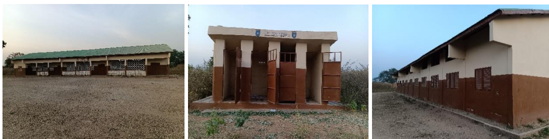
Photo 170 : Montrant l'état de l'ouvrage : Construction module de trois (03) salle de classe avec bureau magasin et équipements plus un bloc de latrine à (04) cabines à l'EPP de Batoko N'Kparou (Lot1
