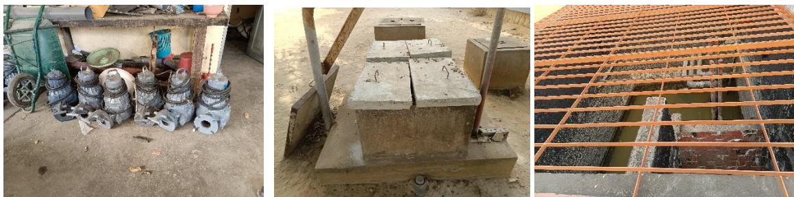
Photo 186 : Montrant l'entretien et la réparation des pompes immergées, des suppresseurs et autres (lot unique).
