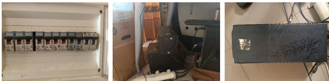
Photo 99 : Montrant la présence physique des matériels électriques.
