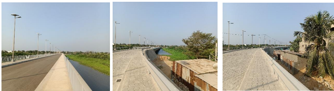
Photo 142: Montrant l'état de l'ouvrage : Second ouvrage de franchissement du bas fond de Womey dans la commune d'Abomey-Calavi (Pont Womey 2.)
