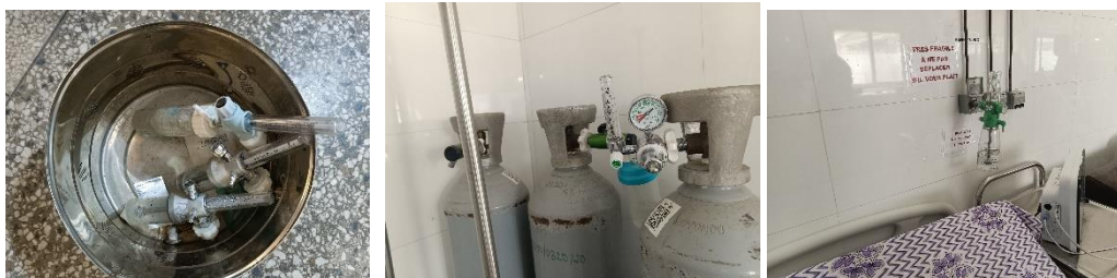
Photo 88 : montrant les manomètres au profit de la centrale de production de l'oxygène du CHU-MEL.
