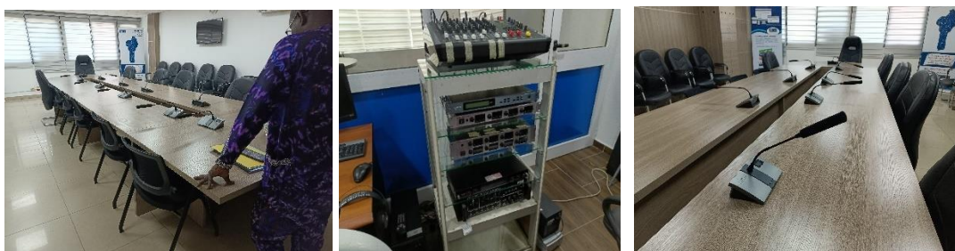
Photo 72 : Montrant les matériels et la mise en place de vidéo-conférence au profit de l'ARCEP BENIN
