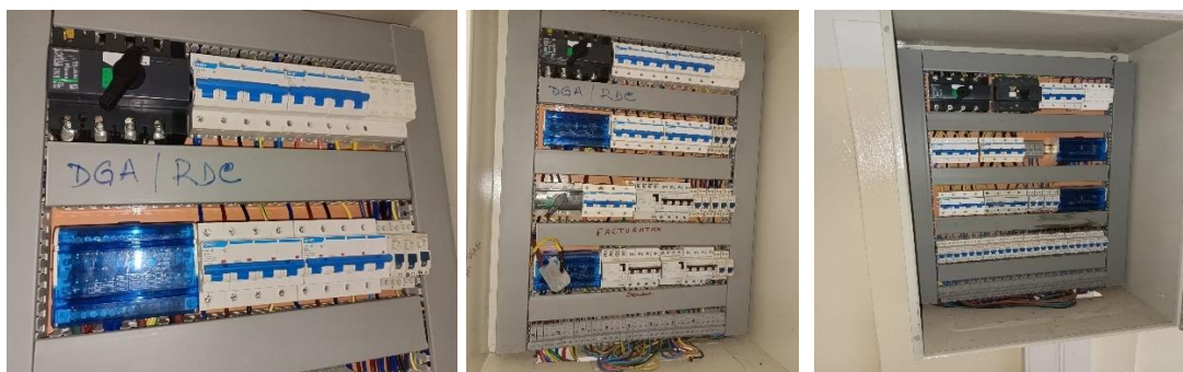
Photo 181 : Montrant Acquisition et l'installation d'armoires électriques et fourniture d'ampoules et autres consommables électriques (Lot 1).
