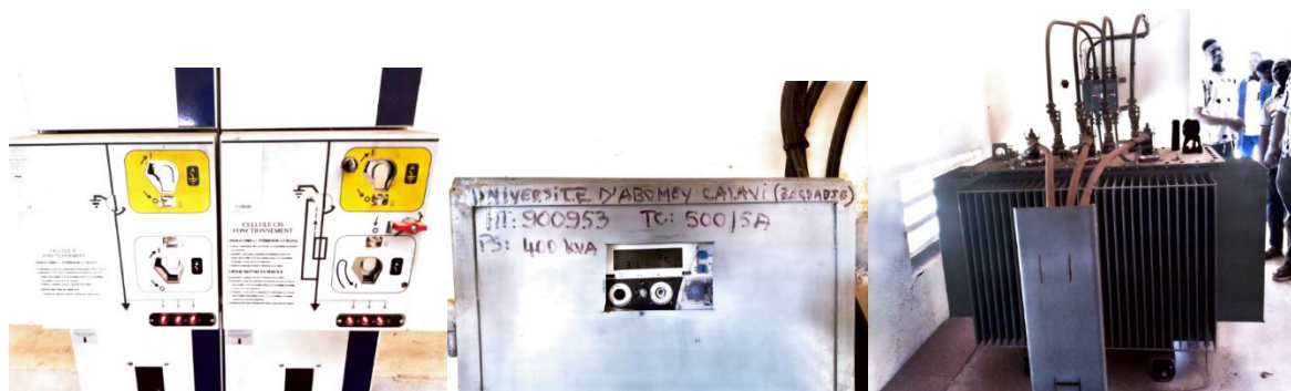
Photo 41 : Montrant les équipements électriques et installation de la nouvelle cabine C128 du Rectorat de l'UAC
