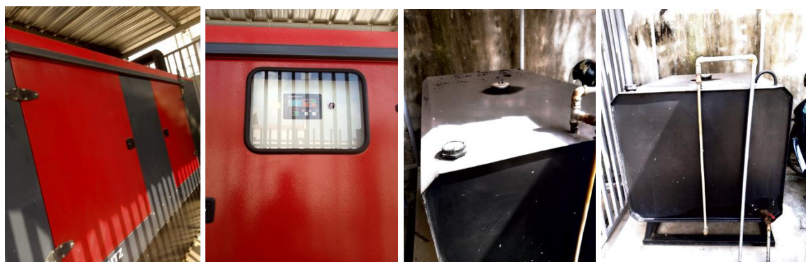
Photo 122: Montrant le groupe électrogène devant être alimenter pas le gasoil.
