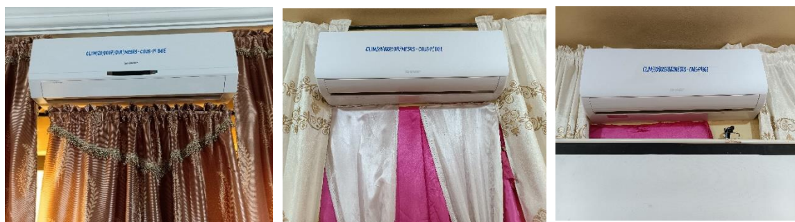
Photo 178 : Montrant quelques climatiseurs installés.
