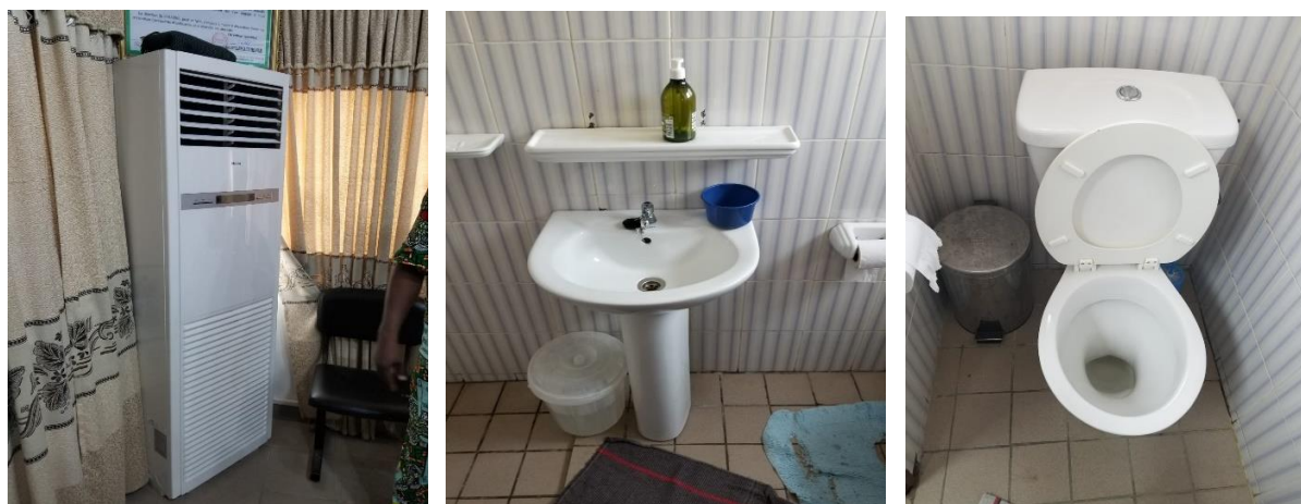
Photo 61 : Montrant des équipements fournis dans le cadre des travaux d'aménagement du centre hospitalier et universitaire de la mère et de l'enfant de la ville de Cotonou
