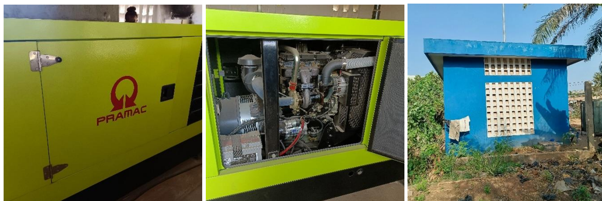
Photo 6 : Montrant le modèle de groupe électrogène acquis et le bâtiment qui l'abrite
