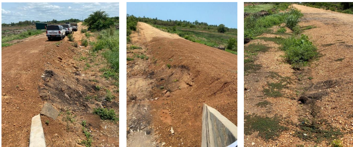
Photo 73: Montrant l'état des pistes de Matékpo à Grand PoPo
