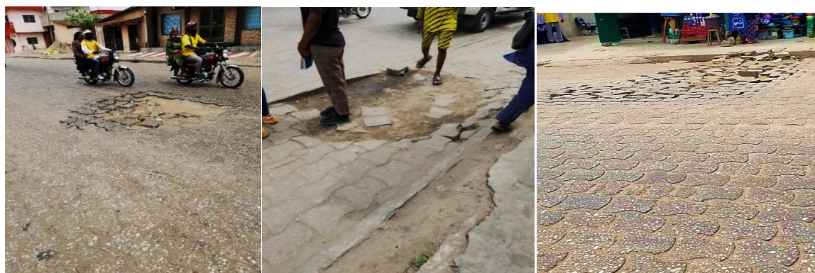
Photo 58 : Montrant la dégradation des rues réfectionnées
