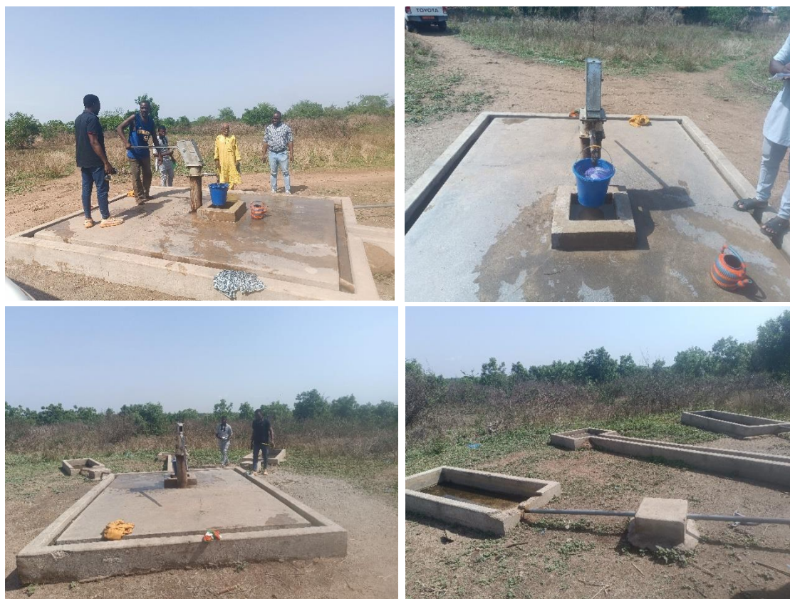
Photo 90_a : Montrant le forage et abreuvoir réalisé à APLAHOUE
