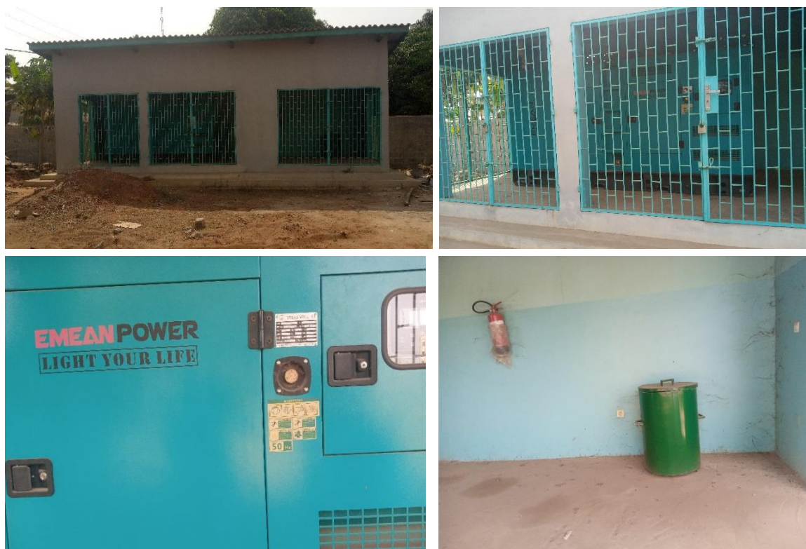
Photo 20 : Montrant le groupe électrogène installé à la Commune de Calavi.
