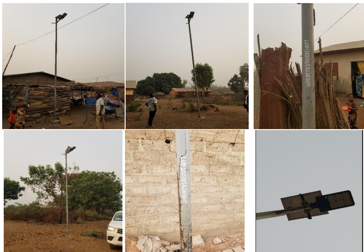
Photo 28 : Montrant l'état des lampadaires solaires acquis et installés.
