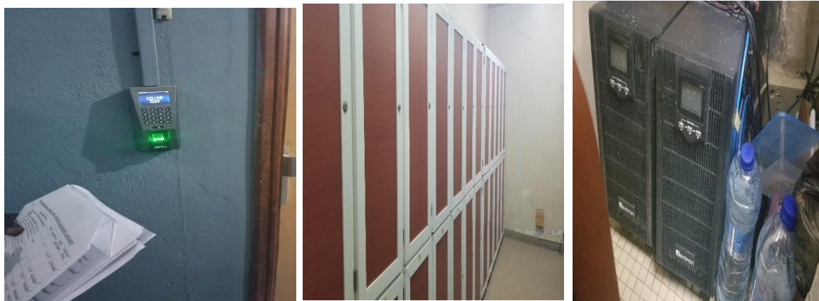
Photo 35 : Montrant les équipements installés, système biométrique et du code d'accès Onduleurs, Placards en aluminium.
