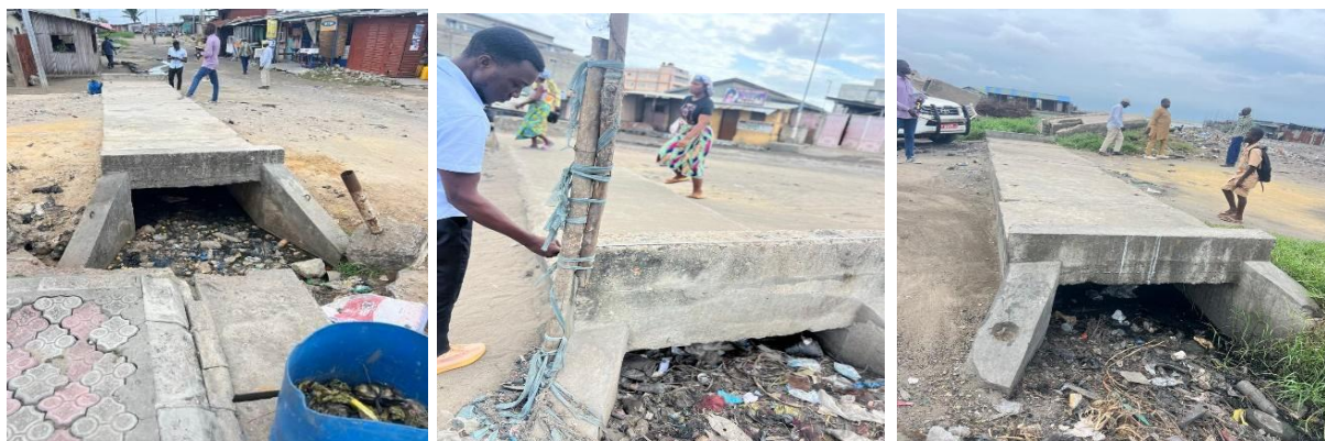
Photo : montrant dalots et dallettes dans les arrondissements de Cotonou
