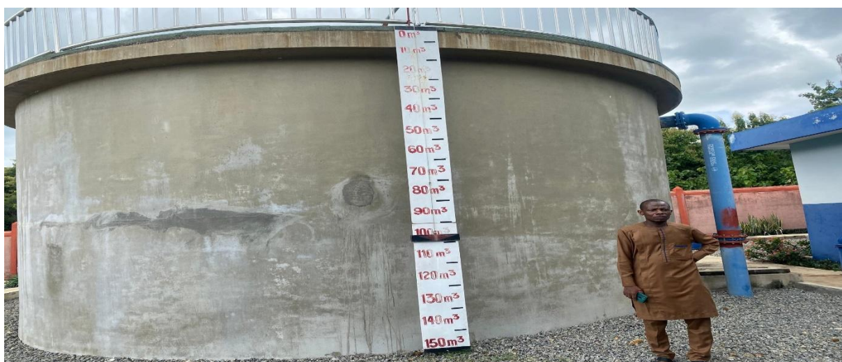
Photo 9 : Bâche de reprise de 150 \text{ m}^3 (conforme)
