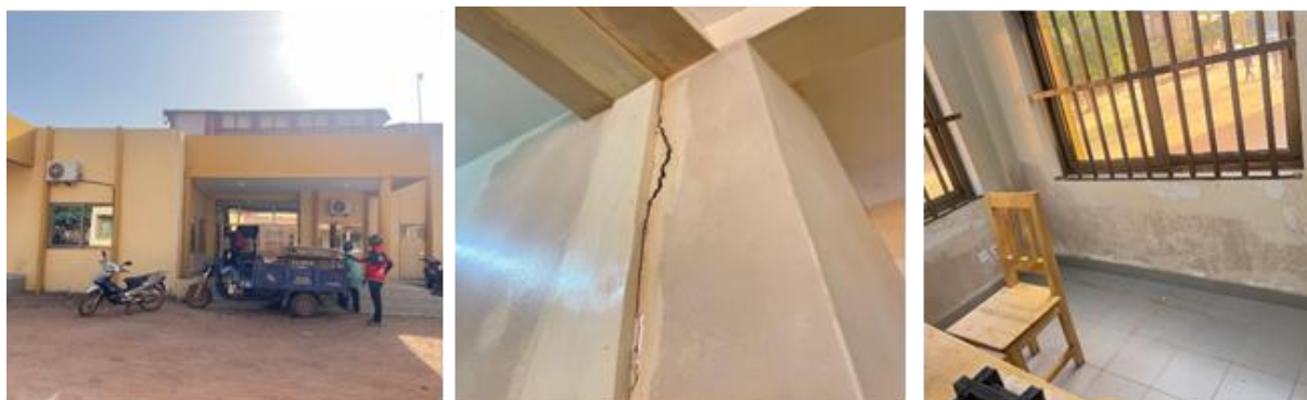
Photo 35 : Montrant les infiltrations d'eau, les défauts de planéité des portes métalliques et les inondations dans le hall d'entrée dues à un mauvais travail d'étanchéité.
