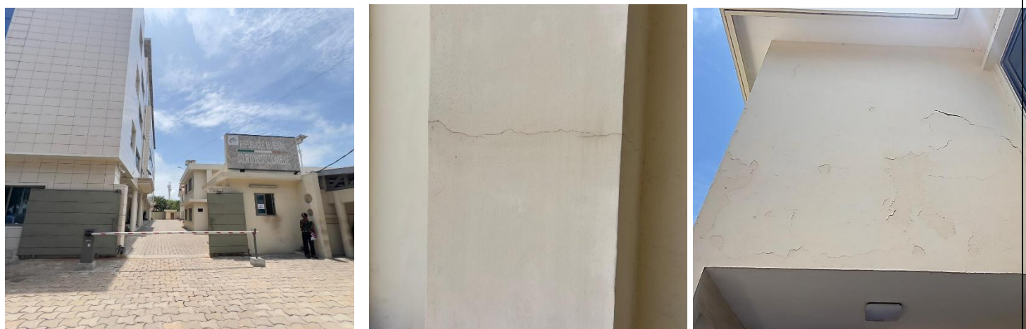
Photo : Montrant l'état actuel des immeubles abritant les bureaux de la Cour Constitutionnelle.
